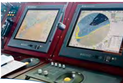
Ausschnitt aus der Brücke des VWFS DENEb: links ECDIS, rechts Radar mit hinterlegter ENC
