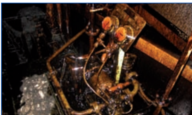
Brandgefahr durch Brennstoffleckage und ölige Putzlappen
