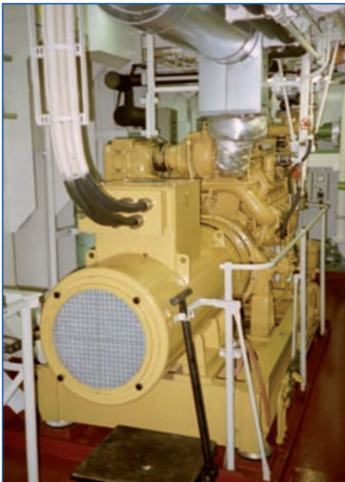
Dieselaggregat an Bord eines Containerschiffes
