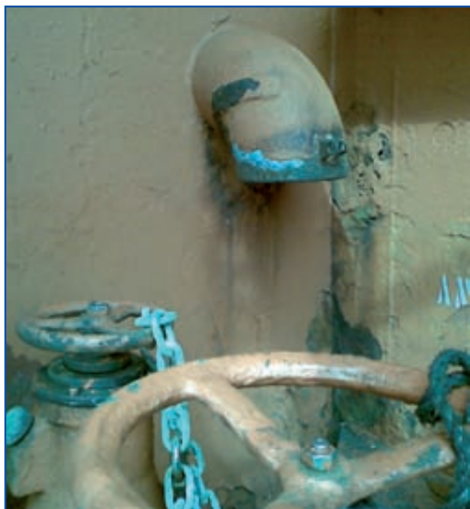
Mangelnde Wartung im Decksbereich
