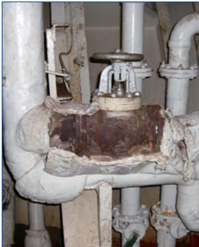
Dampfventil schlecht isoliert
