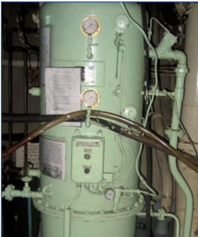
Bilgenwasser-Entöler mit nicht genehmigten Modifikationen
